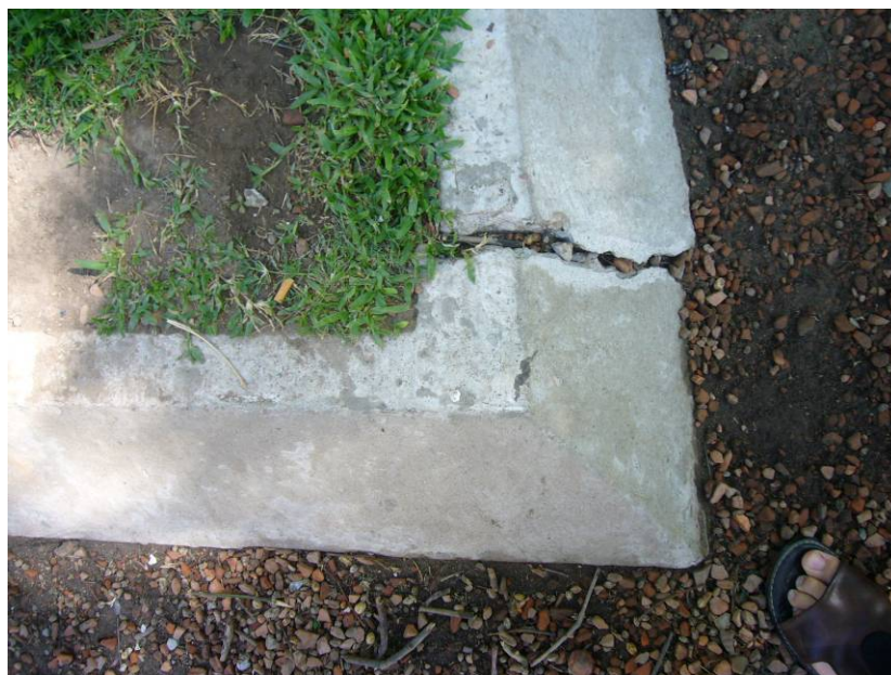
7- Ausencia de juntas en las cazoletas.
