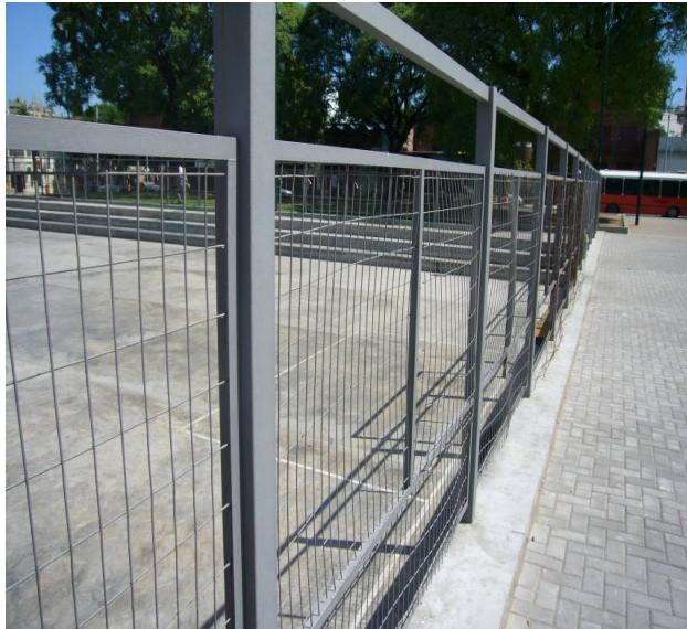
2- Rejas débiles deformadas/desoldadas
