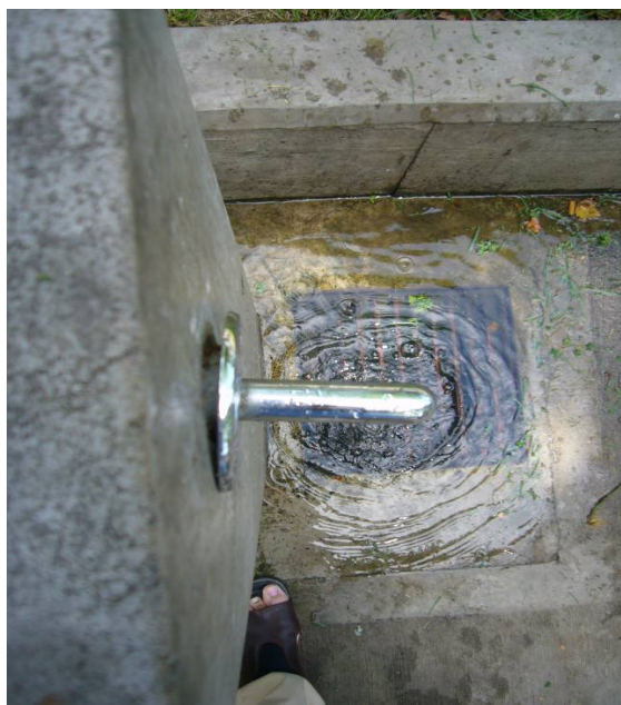
10-Gritería del bebedero mal colocada.
