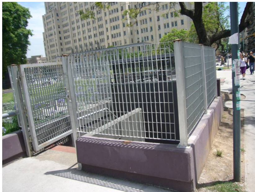
32- Rejas con deficiencias de anclaje y galvanizado.
