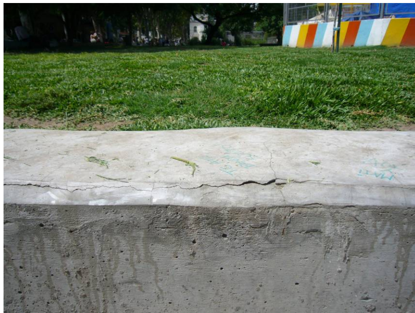
20-Detalles en muretes.
