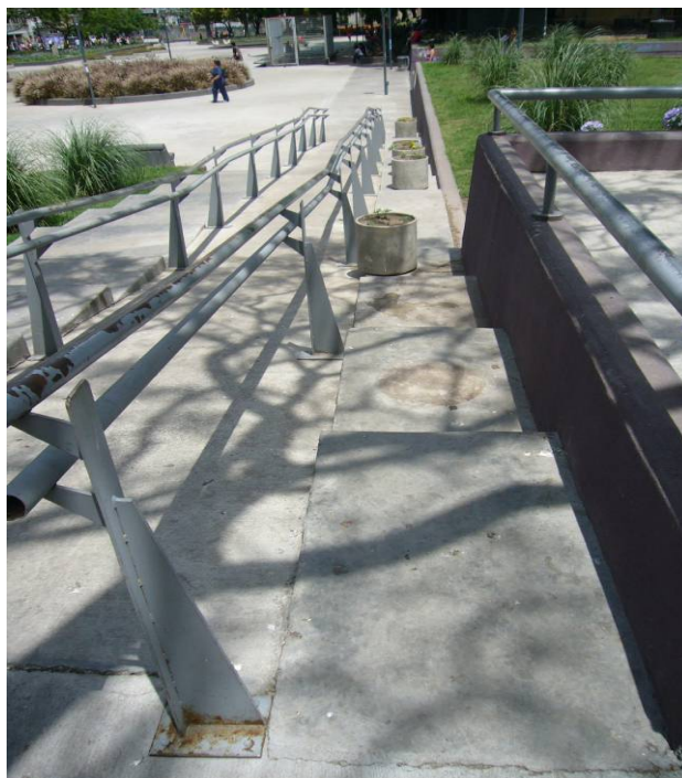
34- Mala realización de rampa y barandas.
