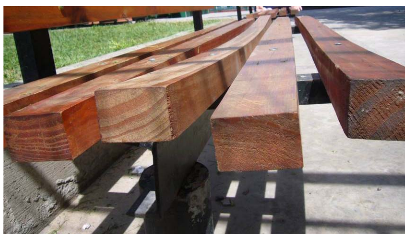
6- Bancos. Detalle de deformaciones.
