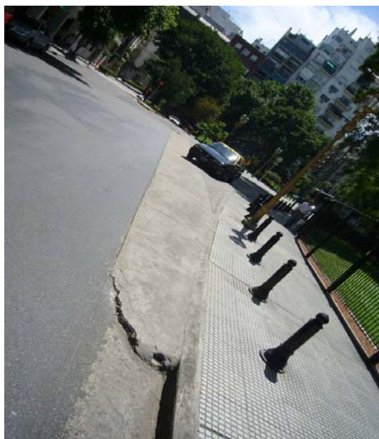
33- Desnivel. Detalle terminación del pluvial.
