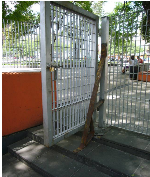
55- Rejas con agregado de soporte precario.
