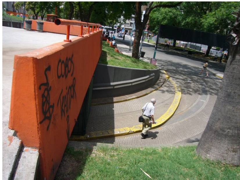
4- Ausencia de barandas.
