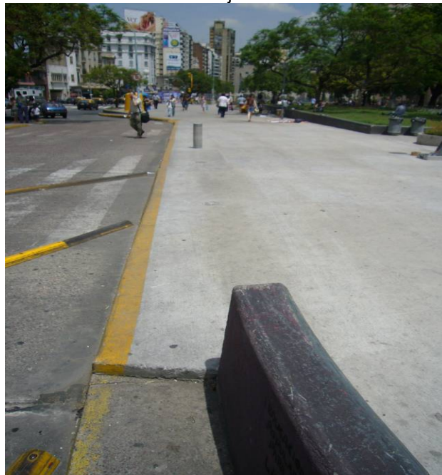
20- Desnivel en el solado.
