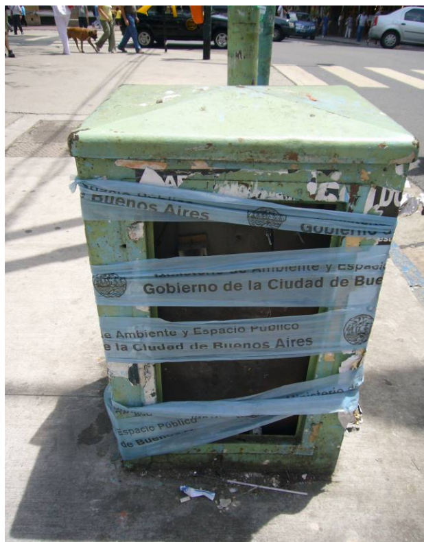
40- Buzón eléctrico con cierre precario.
