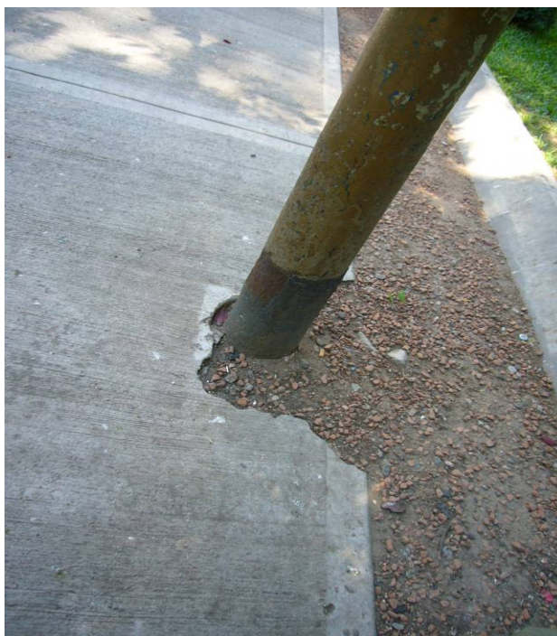
24- Desprolija colocación de piquete.
