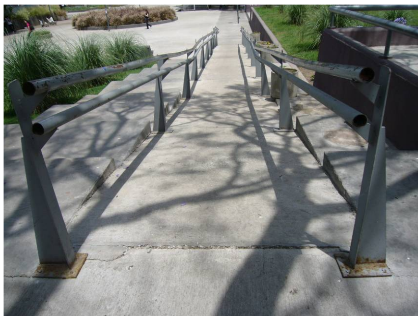
35- Barandas oxidadas, deformes.
