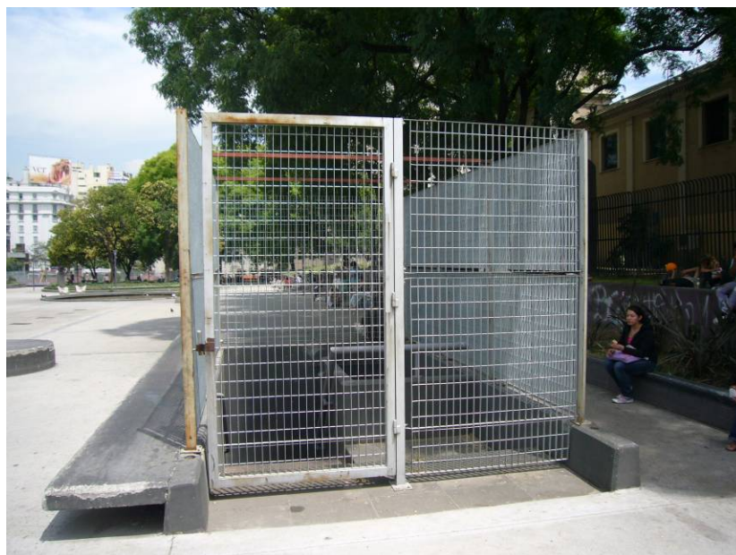
17- Rejas oxidadas con refuerzos por falta de resistencia.
