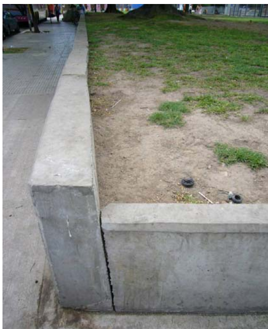
40- Falta de Linealidad de murete.
