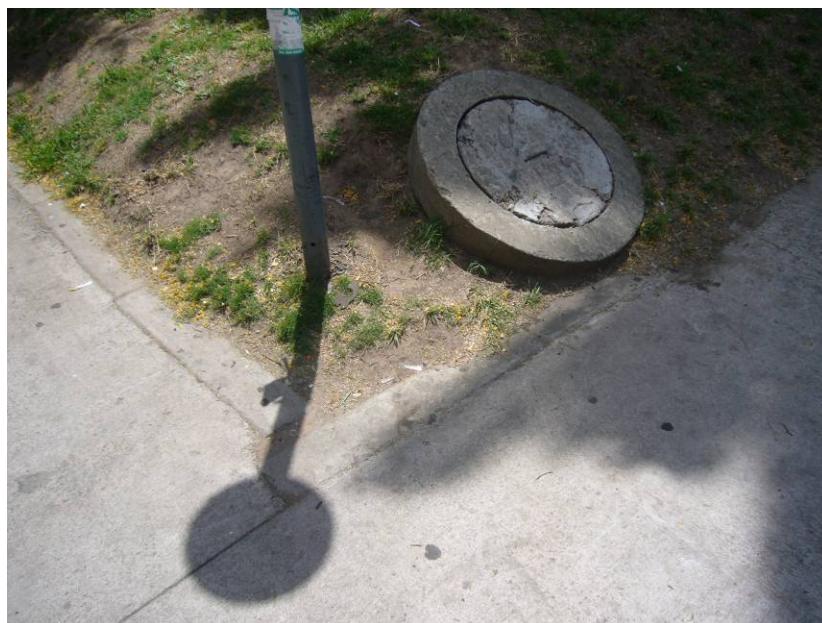
59- Nivel de barranca insuficiente y terminaciones de vereda.
