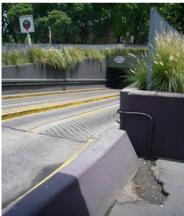
22- Trabajos en estado de abandono.
