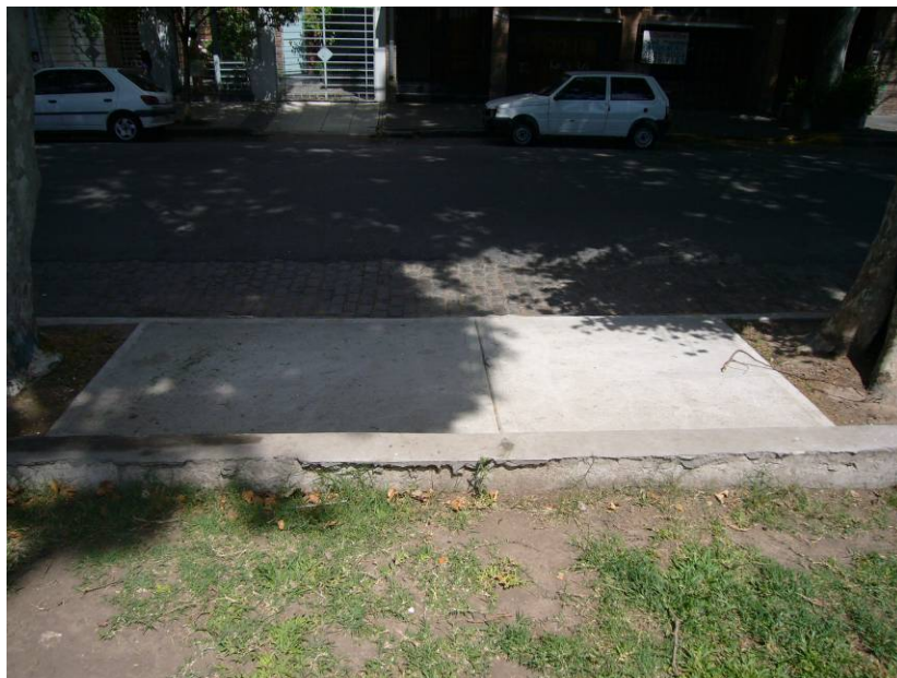
30-Detalle murete mal terminado.
