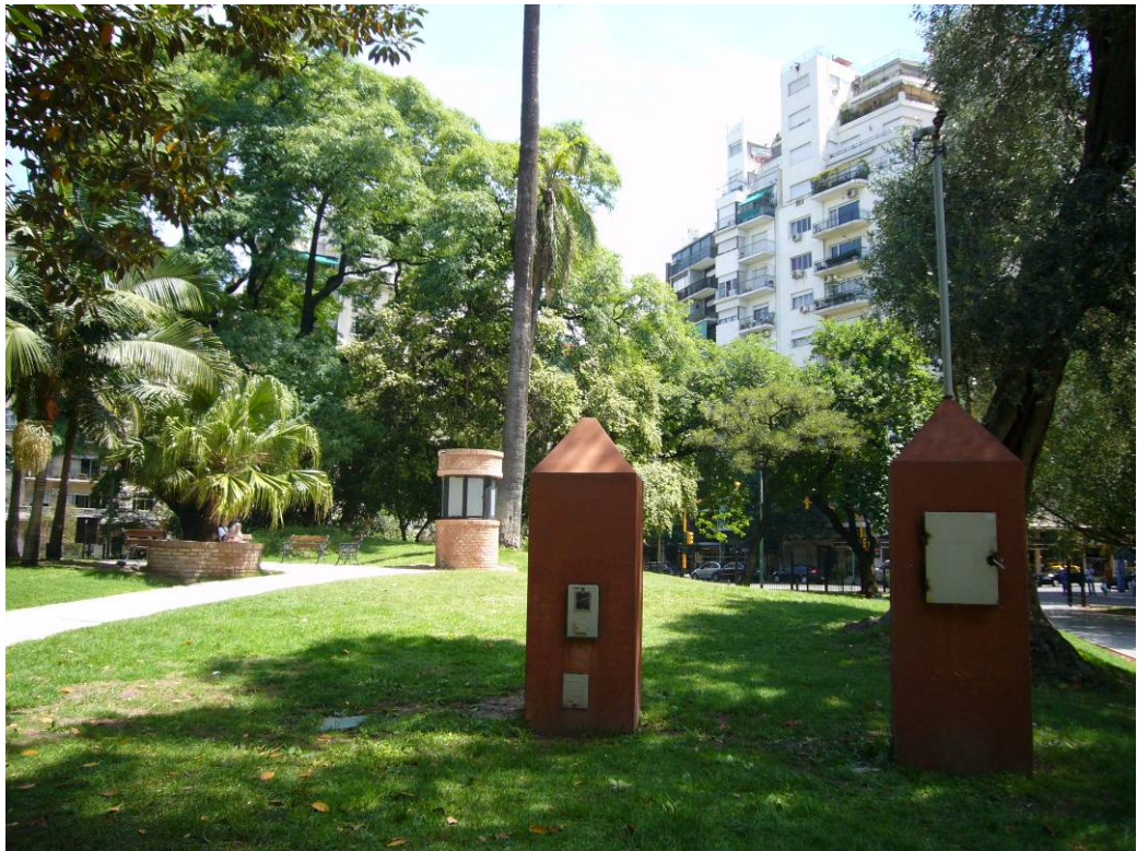
26- Pilar de electricidad y cabina.
