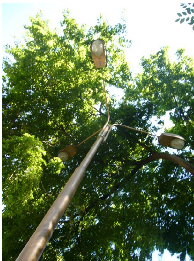
23- Luminarias inadecuadas tapadas por los árboles 82 .
