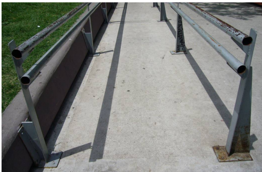
6- Rampa oxidada sin punteras de baranda. Caños de chapa pintada. 84
