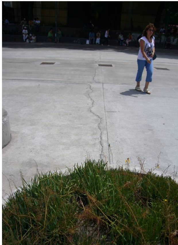
19- Mala realización de juntas de dilatación.
