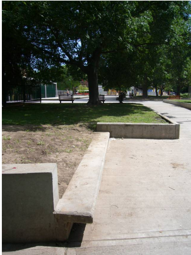
34- Banco de hormigón. La tierra desborda .
