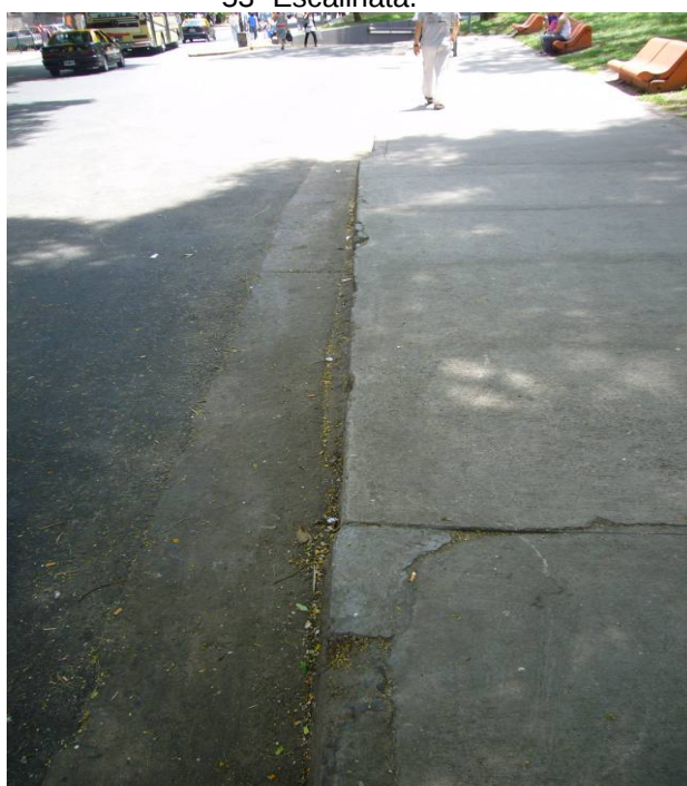
54- Vereda. Bordes. Mala terminación.
