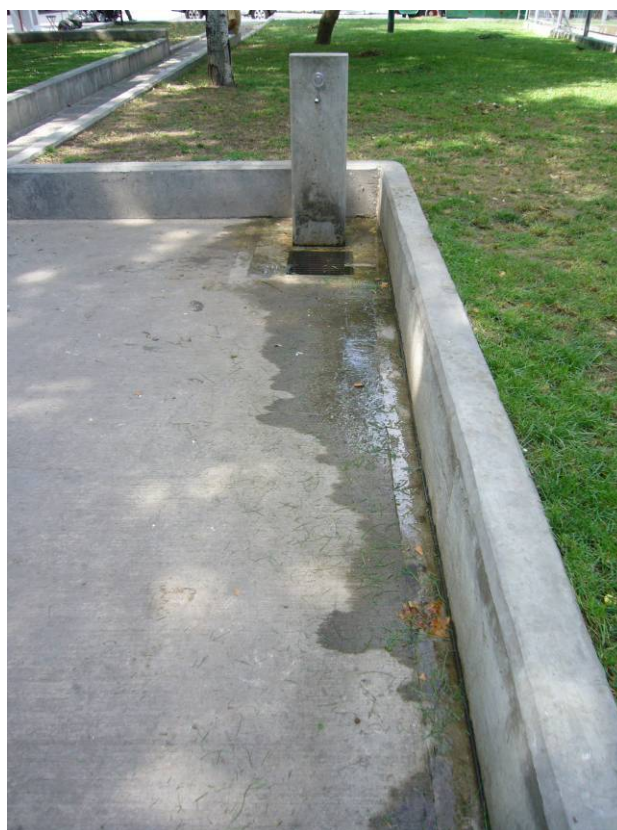
11-Desagüe del bebedero obstruido.
