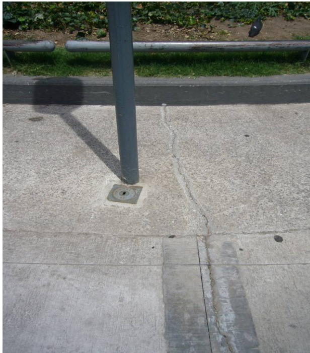
16- Rajadura en solado. Terminaciones irregulares
