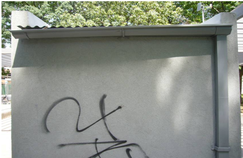
12- Canaleta de la casilla vencida
