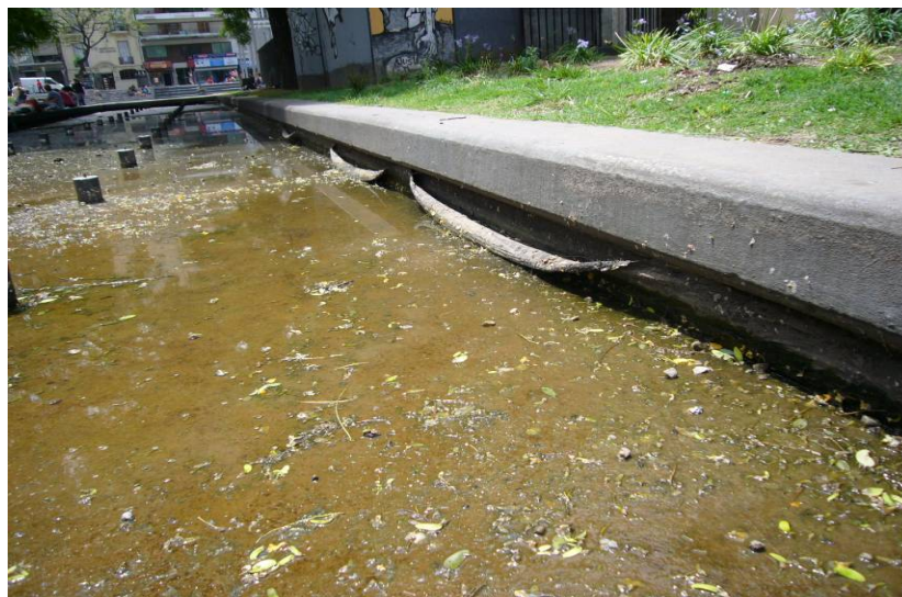
11- Capa hidrófuga despegada
