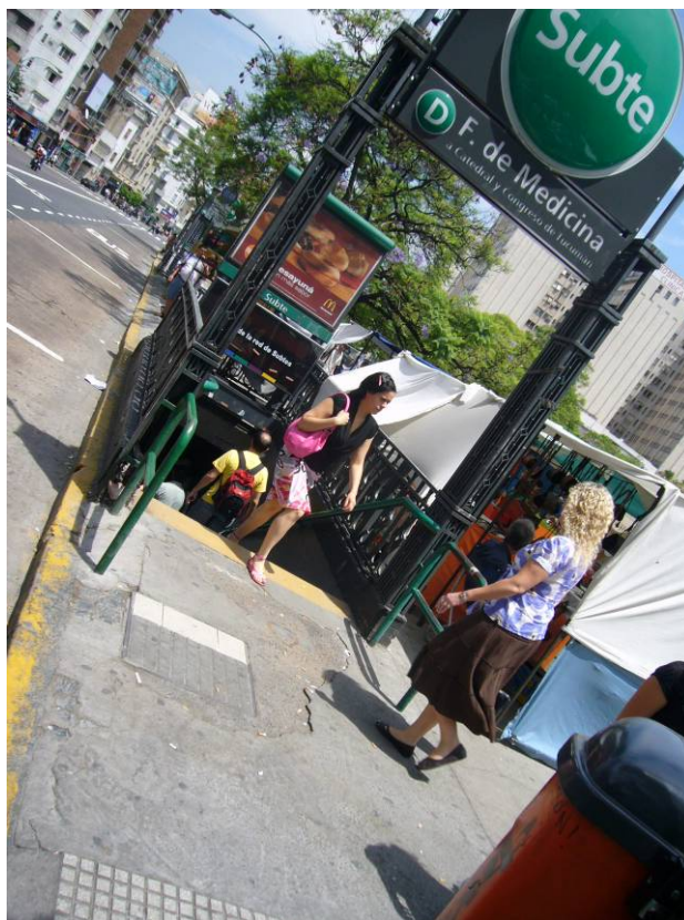
23- Mala ejecución de solados frente al subte
