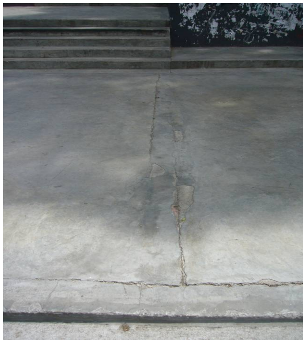
15- Ausencia de juntas adecuadas.
