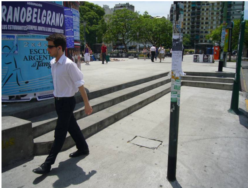
51- Resolución de desniveles. Tapa inadecuada.
