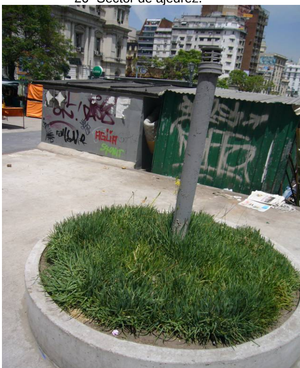
27- Caño que reemplaza la ventilación original
