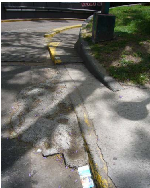
1- Pastón de cemento abandonado en la calzada.
