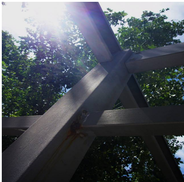
7-Pérgola. Detalle de oxidaciones.
