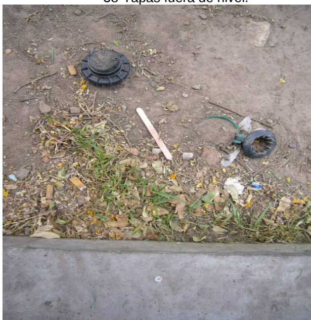
39-Sistema de riego en mal estado
