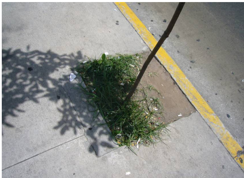
46- Mala terminación de vano para los árboles.
