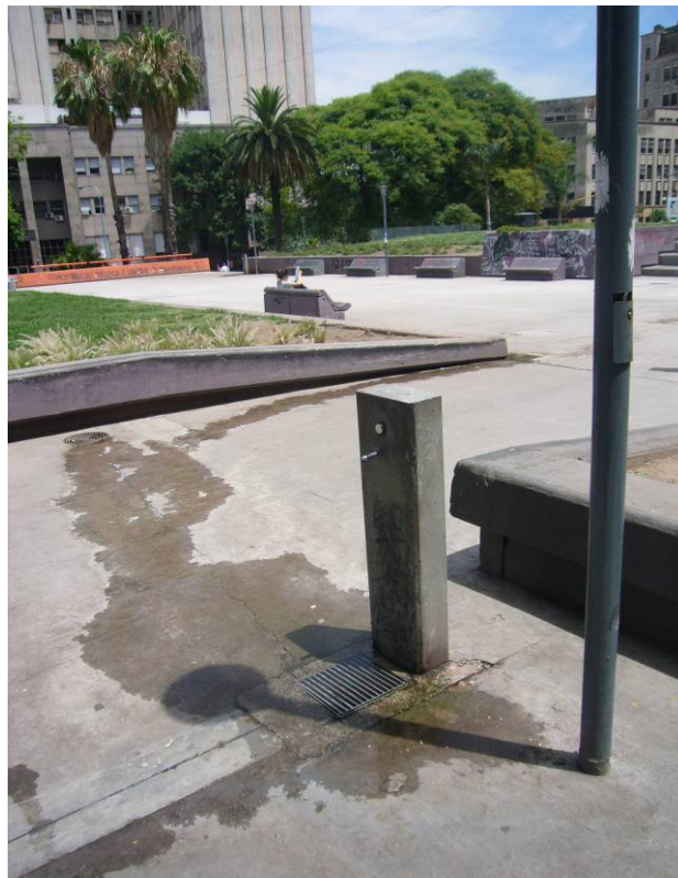
13- Desagüe de bebedero obstruido.
