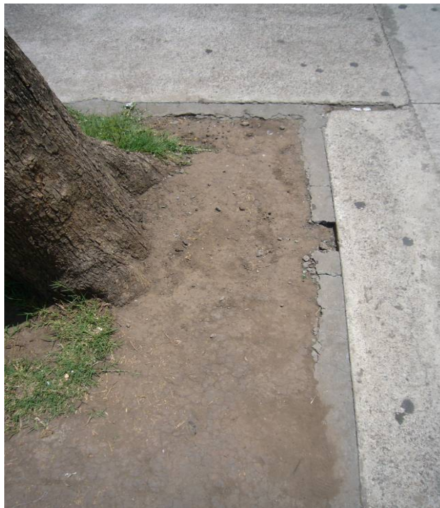
37- Mala terminación de bordes.
