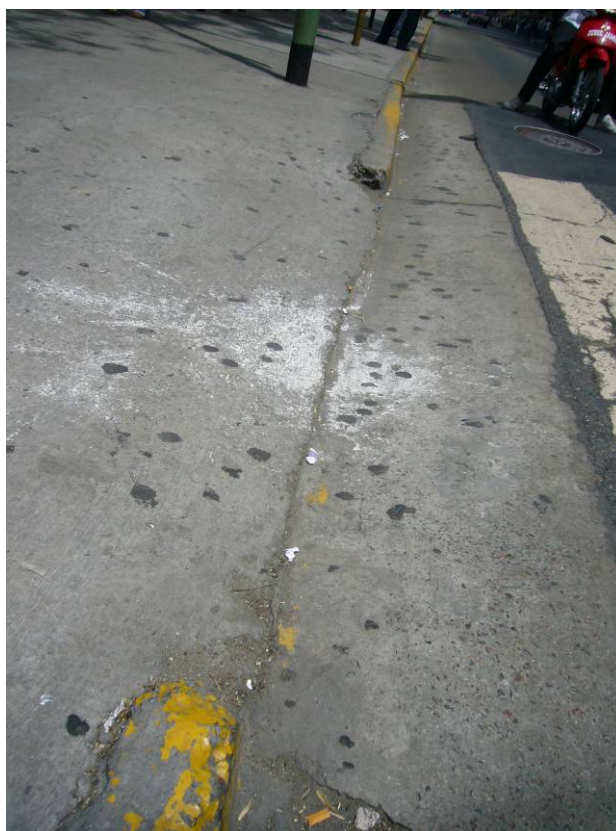
45- Mala terminación de rampa en vereda.
