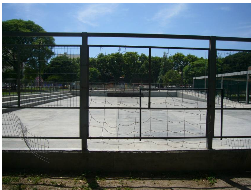
29-Rejas Polideportivo rotas y remendadas con alambre.
